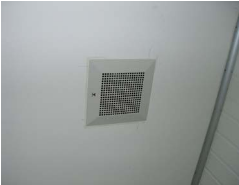
ภาพที่ 18 ระบบระบายอากาศในห้องผลิต
